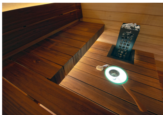
Bastuaggregat och vattenskålar kan integreras i bastuinteriören.
