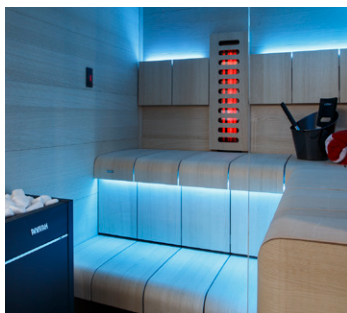
LED-list bakom ryggstöd och under lavefronten.
